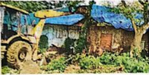
वसई एसटी डेपोनजीक असलेल्या एका घरावर पालिकेच्या अतिक्रमण विभागाने कारवाई केली.
